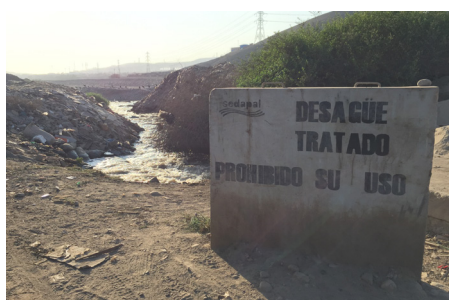
Imagen 1. Planta de tratamiento de aguas residuales
